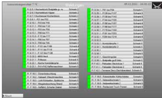
Löst ein FI aus, wird sofort eine SMS an den Techniker abgesetzt, der gerade Bereitschaft hat.
