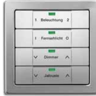
Zwei Edelstahl-Tastsensoren (Busch-Jaeger) im Thekenbereich wurden als zusätzliche Bedienmöglichkeit installiert.
