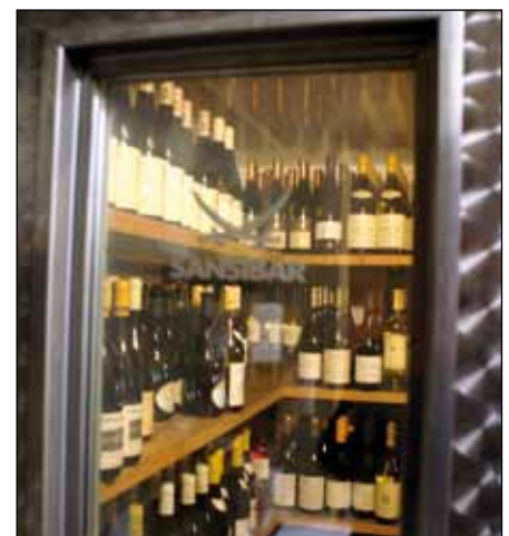
In den Kühlräumen wird nicht nur Wein temperiert – hier lagern auch Nahrungsmittel. Würde ein FI-Ausfall nicht bemerkt, könnte schnell hoher Schaden entstehen.
