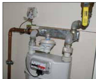
Beispiel Gasuhr: Über eine Schnittstelle werden die Werte via Tasterschnittstelle an KNX weitergegeben und von dort über das Ethernet-Gateway eibPort an den Service von find-your-energie verschickt.
